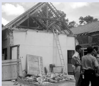
学校の校舎。地震で倒壊したため取り壊し処分中。右が建設中の新しい校舎。
