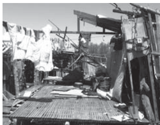
台風2号の被害を受けたチャイルドの家(センター21)
