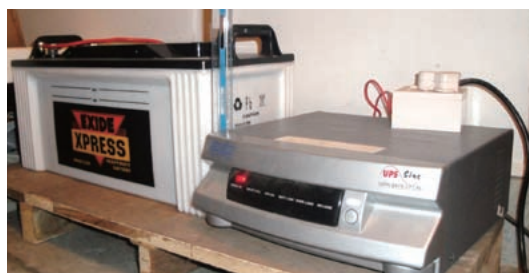
家庭に設置してあるバッテリー(左)と整流器
